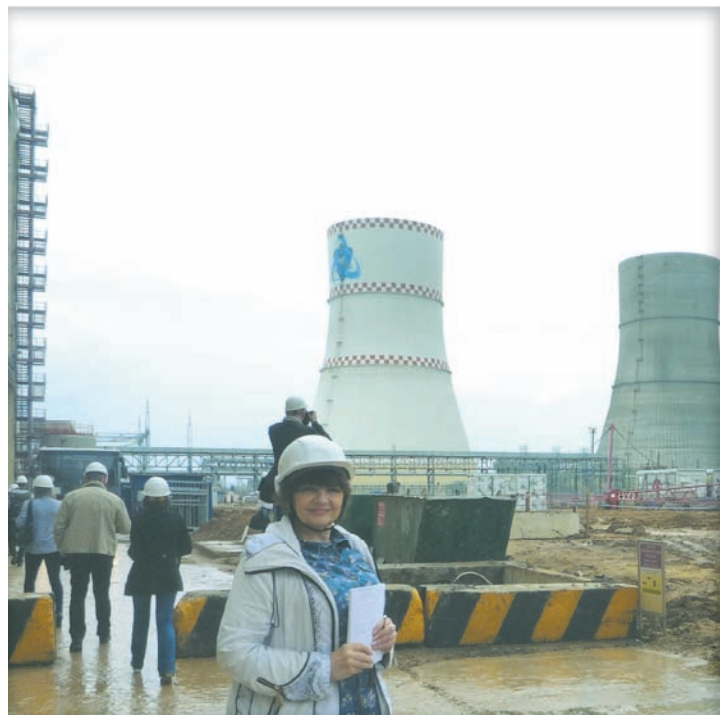
Башенно-испарительные градирни третьего действующего энергоблока (с логотипом Росатома) и строящегося четвёртого
