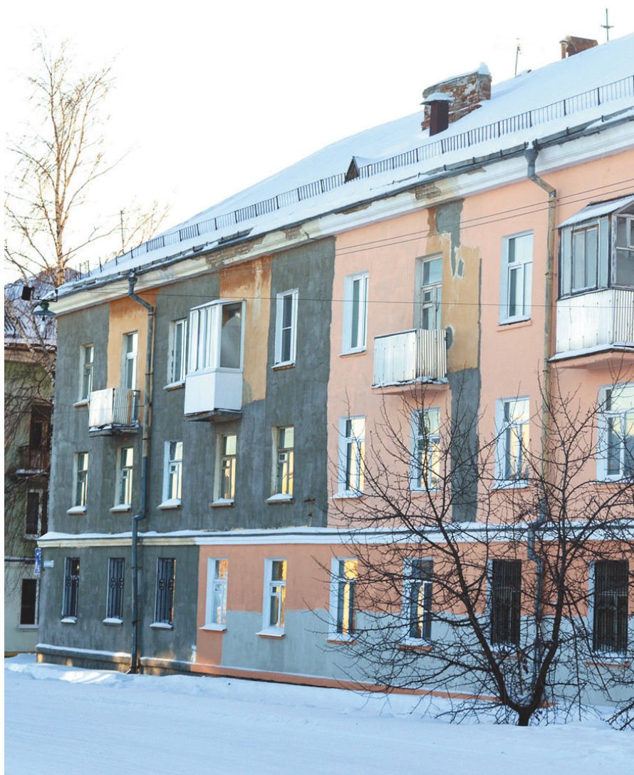
В доме № 3 по ул. Белинского ещё в 2015 году начат капремонт и до сих пор не завершён...
